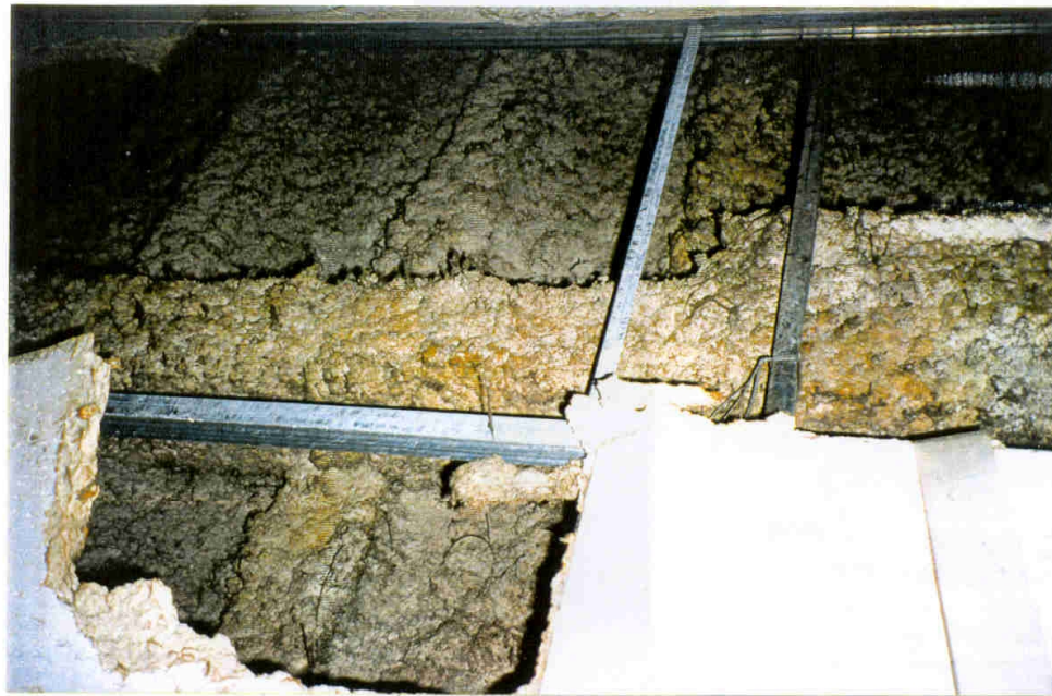
Fotografia n. 9 - Amianto spruzzato a soffitto visibile dopo rimozione di controsoffittature
